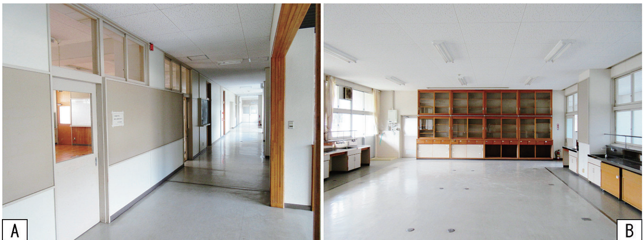
図9 F小学校の教室の現況写真(A:1階廊下, B:3階家庭科室).
